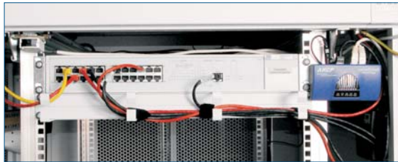
Abb.: sensorProbe2 Vor-Ort im Einsatz. Dank ihrer kompakten Bauweise ist sie fast überall zu installieren. Ihre Infrastruktur ist somit wirksam geschützt.
